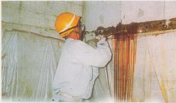
Xử lý rò rỉ nước cho tường tầng hầm
